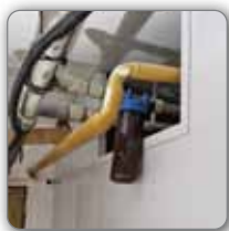
Anpassung an Kellerverteilungen
