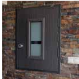
Absicherung eines Elektrizitätsmessers, Sicherheitsklasse 3 plus
